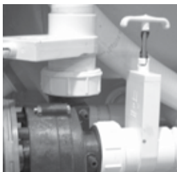
Vanne guillotine et raccord-union de la pompe
