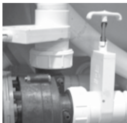
Vanne guillotine et raccord-union de la pompe
