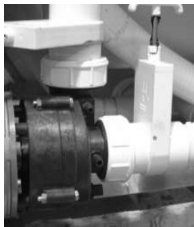
Vanne guillotine et raccord-union de la pompe
