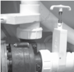
Scheibenventil und Pumpenanschluss
