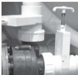
Vanne guillotine et raccord-union de la pompe
