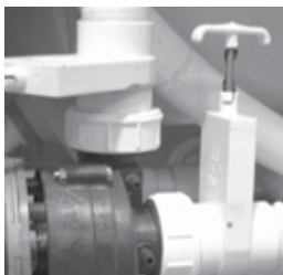
Scheibenventil und Pumpenanschluss
