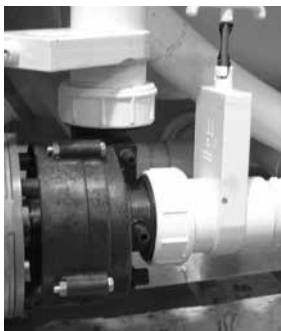
Scheibenventil und Pumpenanschluss
