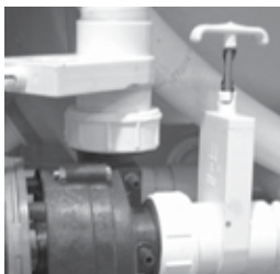
Scheibenventil und Pumpenanschluss
