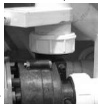
Vanne de coupe et raccord de pompe
