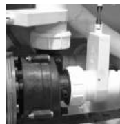
Vanne guillotine et raccord-union de la pompe
