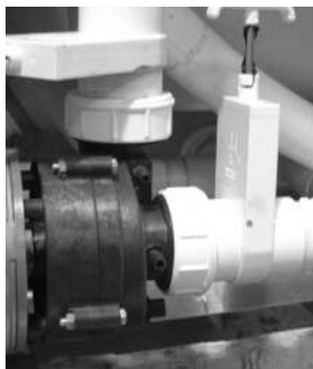
Scheibenventil und Pumpenanschluss
