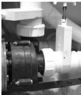
Vanne guillotine et raccord-union de la pompe
