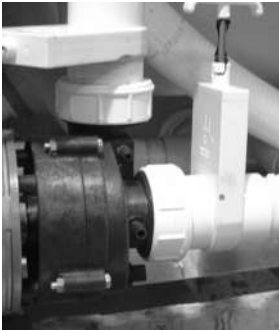
Scheibenventil und Pumpenanschluss
