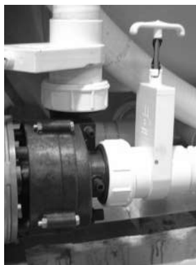
Vanne de coupe et raccord de pompe
