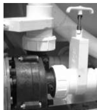
Scheibenventil und Pumpenanschluss
