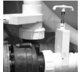
Scheibenventil und Pumpenanschluss
