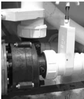
Scheibenventil und Pumpenanschluss
